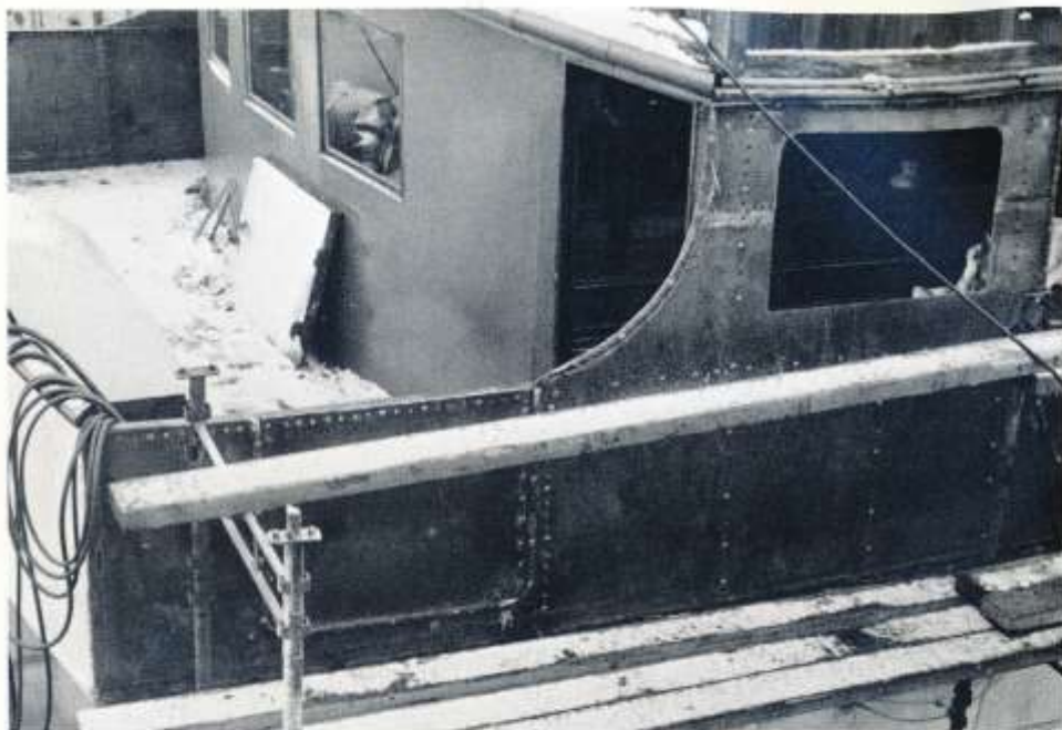
Vindskyddet på promenaddäck var svårt rostangipna och förnyades därför under varvsvistelsen. Här syns även portarna i brädgången som åter gjorts öppningsbara.
